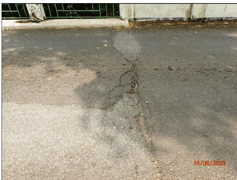
Kryt vozovky nad O2, pohled v příčné linii mezi NK a křídly.
