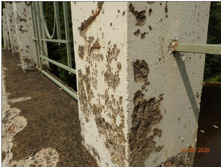
Detail poruch na plášti P zábradelního sloupku.
