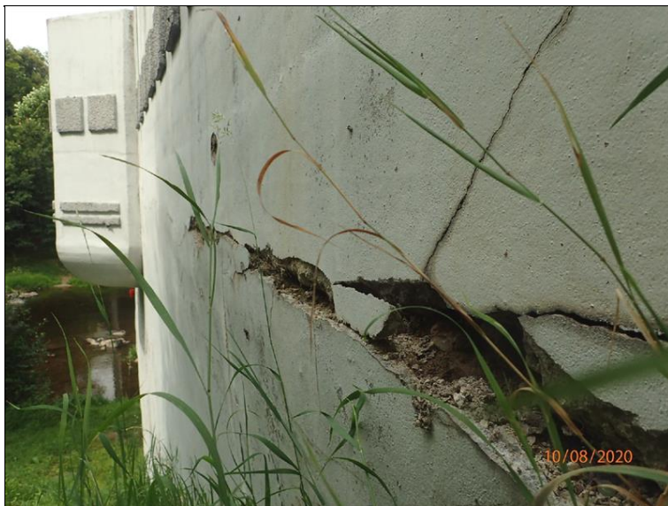
Detail poruchy v líci L křídla O1.
