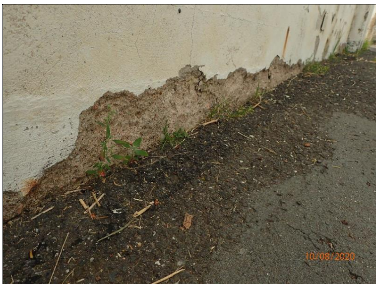
Detail poruchy v patě L zábradelní zdi nad O1 z výše uvedené foto.
